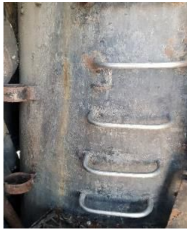
Prise de vue des barreaux du sas passerelle de la FLORE
